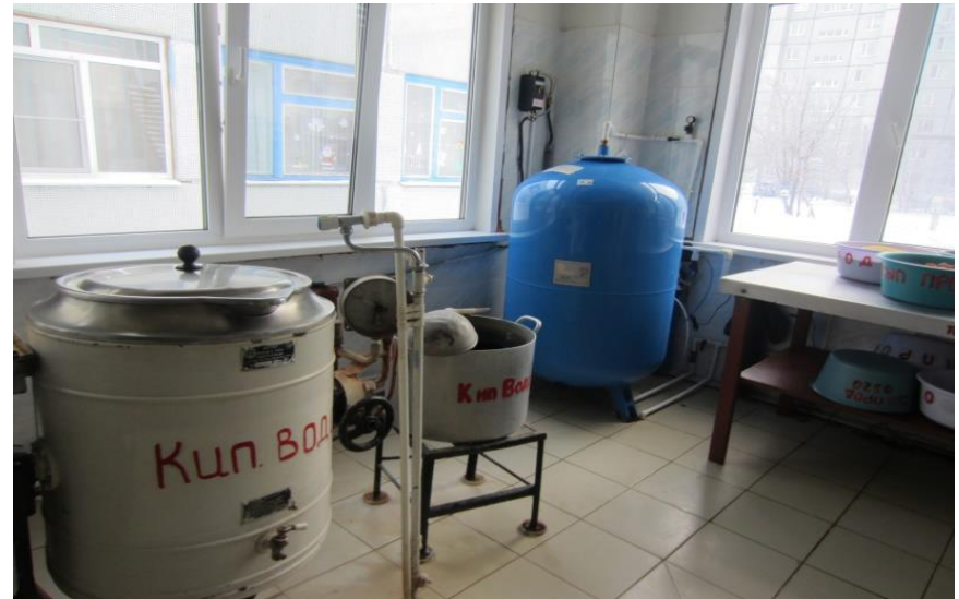
Система очистки воды
